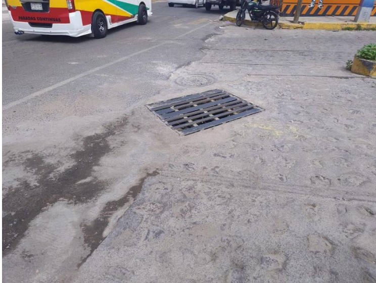
Coladera Av. 18 de Marzo 2
